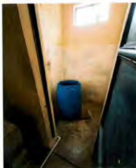
Foto 5: Situación inadecuada de ducha (a remozar)
