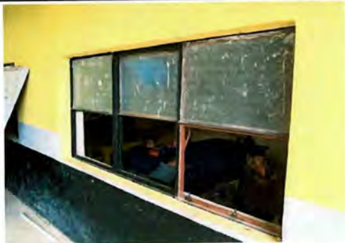
Foto 1: Situación de ventanería en mal estado
