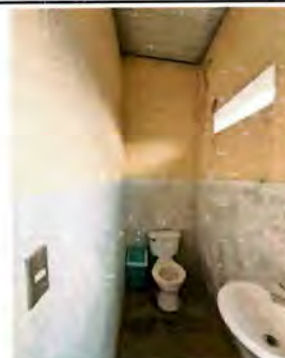
Foto 4: Situación de baños y lavamanos en mal estado (baño a remozar)
