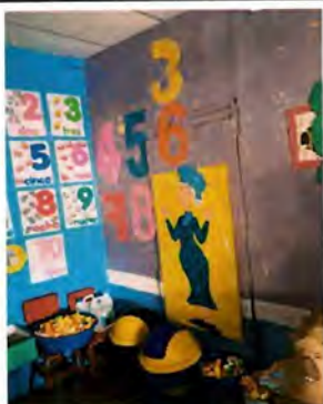
Foto 3: Situación de puerta en mal estado (a sustituir)
