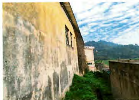
Foto 6: Pared en mal estado (deberá remozarse)
