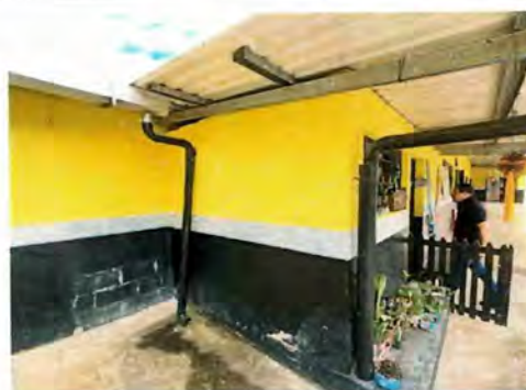
Foto 2: Situación de lámina sin canales
